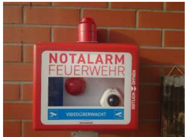
Notalarmknopf beim Eingang zum Feuerwehrmagazin in Niederrohrdorf
