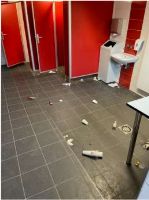
(Foto 2: Sachbeschädigung Toilettenanlage Kollerhaus)
