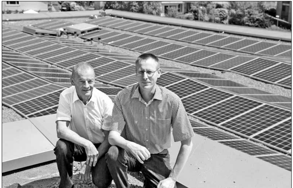
Gemeindeammann Kurt Scherer (links) und EOR-Präsident André Meier freuen sich über die Inbetriebnahme der leistungsfähigen PV-Anlage auf dem Schulhausdach in Oberrohrdorf.
